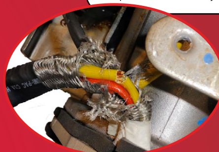
Poškozené nebo přerušené kabely
